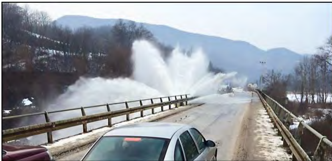
Слика 11. Хаварија на краку за Лучане магистралног цевовода водосистема „Рзав“ – мост преко Западне Мораве код Кратовске стене (25.01. 2016)
